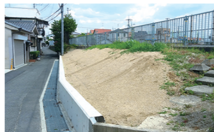
平成31年3月 松原市別所6-12-30付近の法面が崩れていたため、整備をさせていただきました。
