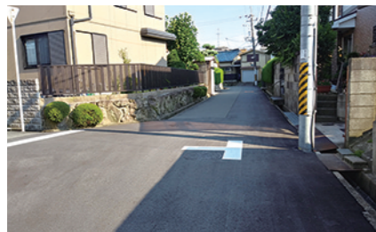
令和元年6月 松原市小川1-9-12付近 安全確保のため交差点マークを標示させていただきました。
